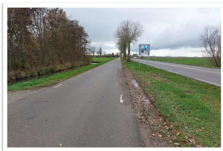
Foto 15: Schade aan berm als gevolg van smal profiel parallelweg Graaf Reinaldweg
