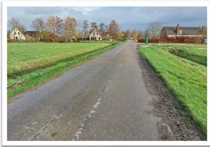
Foto 16: Schade aan berm als gevolg van smal profiel Korfgraaf west
